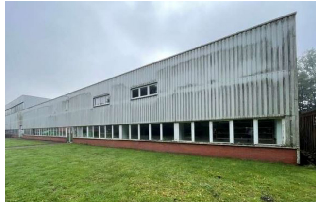
Industriegebäude mit Asbest.
