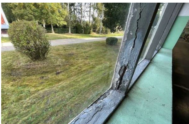
Betriebsvermögen mit Asbest.
