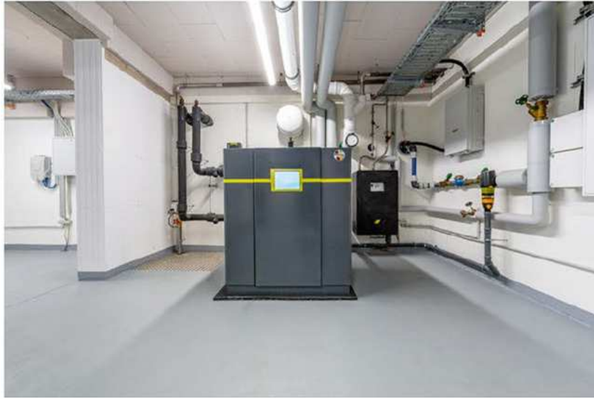
Musterstraße XX, Musterstadt – Fernwärmanlage
