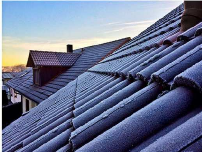
Musterstraße XX, Musterstadt – Dachflächen, teilsaniert
